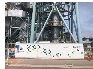
CO2回収デモ機 外観
